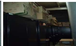
Área sin medidas de seguridad
