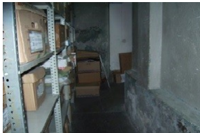
Área contacto con humeda
