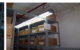
Instalaciones electricas no funcional
